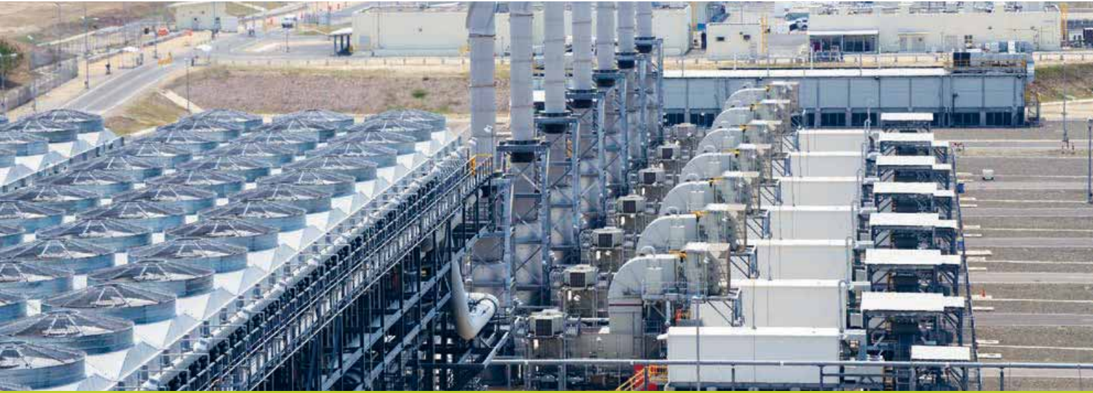
LNG Plant site generators
